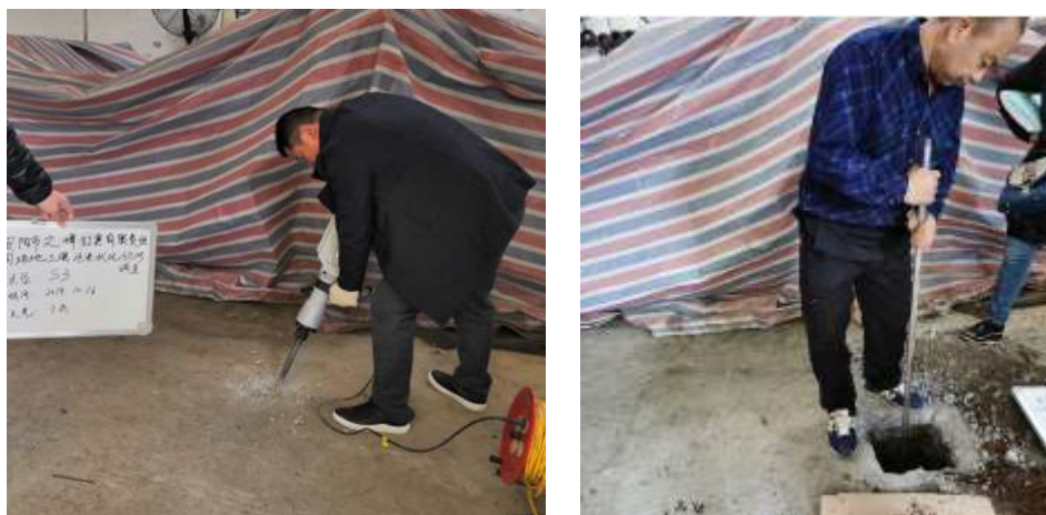
图 3-6 现场地面破孔和土壤取样
